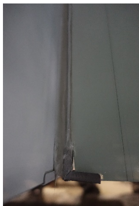
圖 12 試體 T 型接合處填縫膠損壞情形
