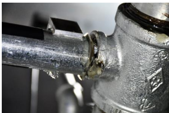
(a) 支管損壞狀況
