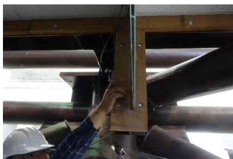
圖 11 試體端部填縫膠損壞情形
